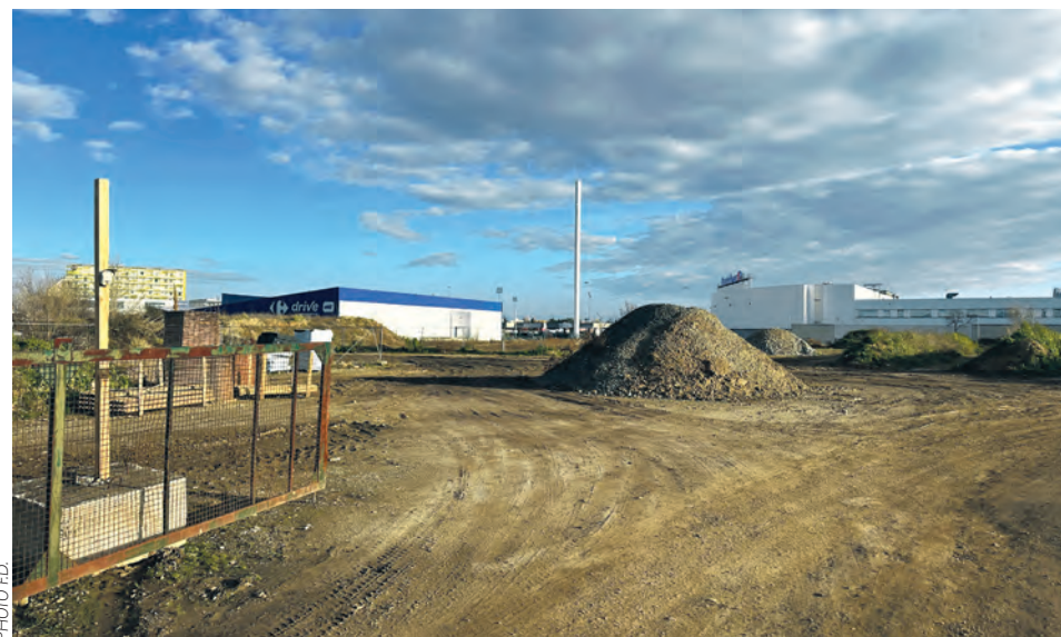
Sur cette parcelle, les terres sont valorisées pour être réemployées sur le chantier du T10
